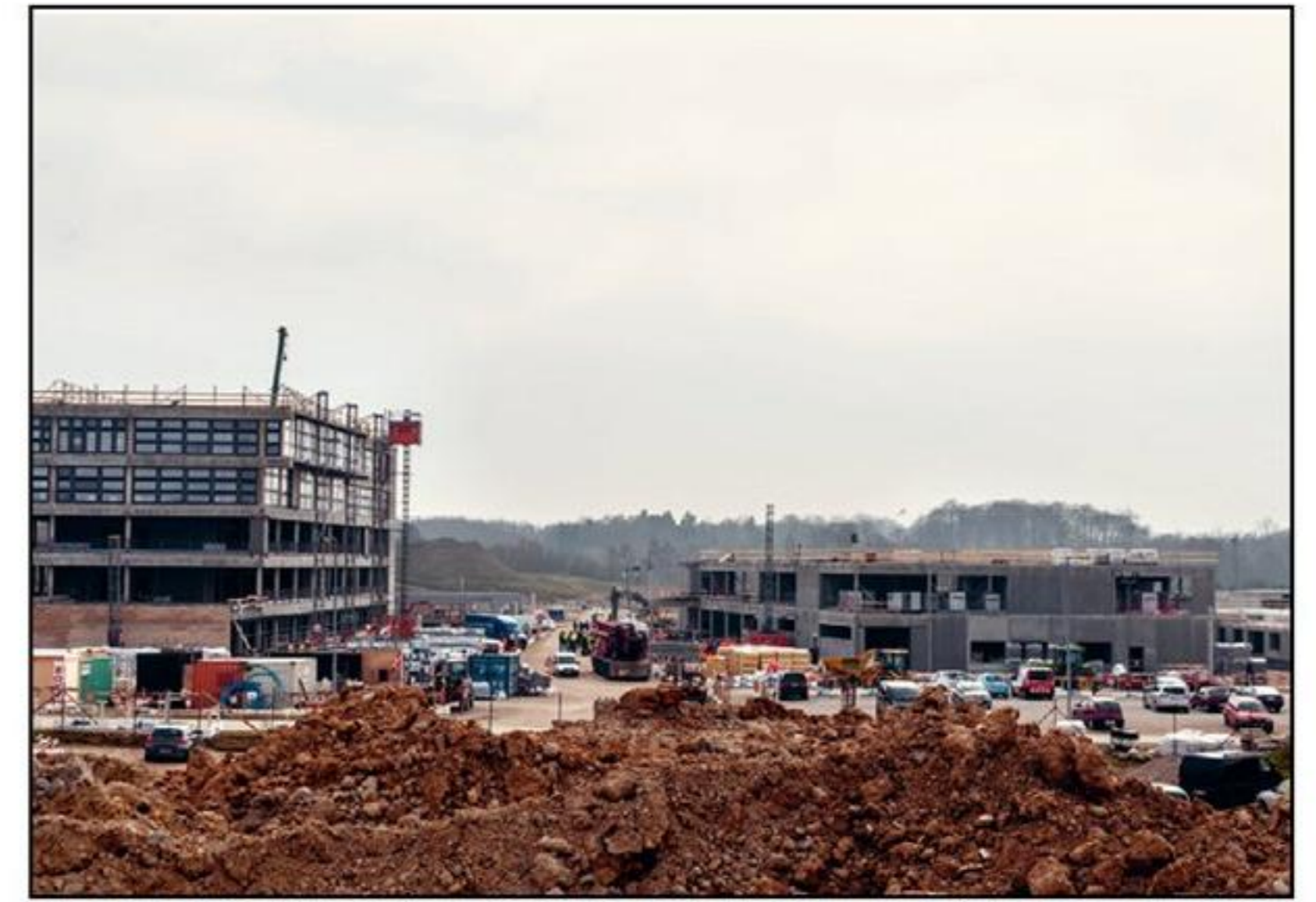
Den 5 etager høje servicebygning kommer bl.a. til at danne ramme for et videns- og forskningscenter
