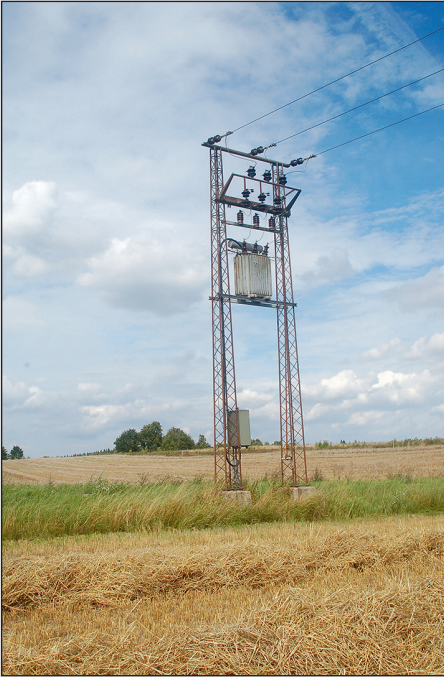
Foto: Morten Høeg, projekt om transformerstationer og højspændingsmaster, 'Foto med nye øjne'
